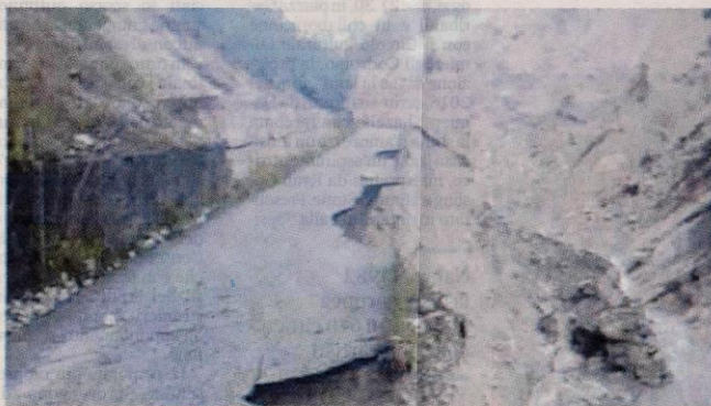
Ecco la situazione della strada della Val Settimana dopo il maltempo di ottobre 2018
